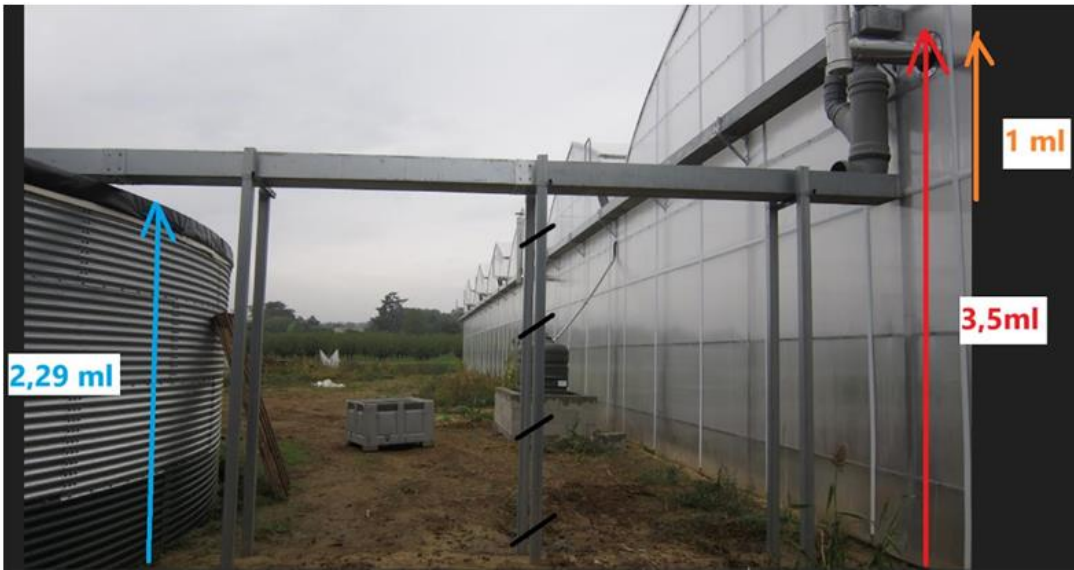
Figure 21 : Collecteur est aérien vers les réservoirs d'eau de pluie
