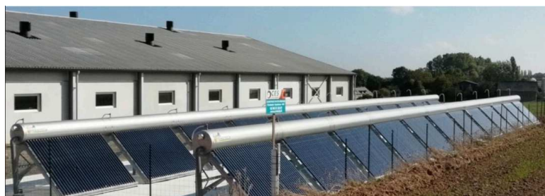
Figure 10 : prise de vue du chauffe eau solaire
