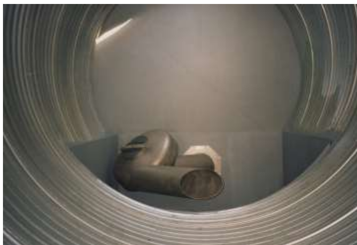
Photo du régulateur de débit posé dans l'ouvrage
