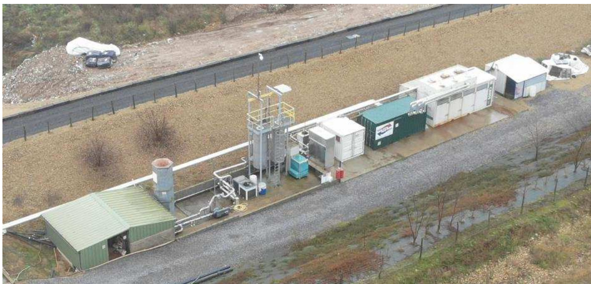
Figure 106 : Vue sur les turbines et unité de valorisation du biogaz
