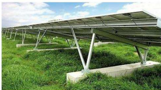
Figure 146 : Illustration de panneaux avec des longrines béton comme fondations
