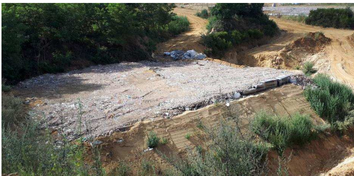
Figure 138 : Couverture du casier amiante par des gravats triés
