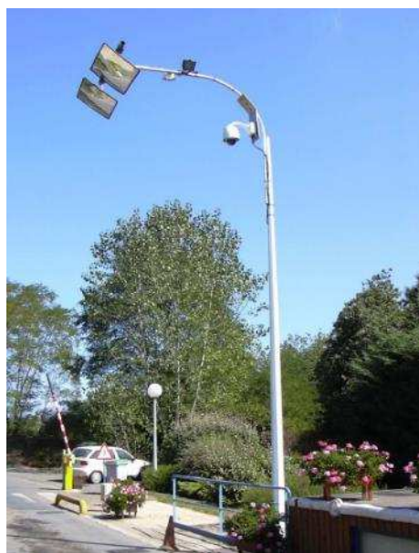
Figure 11 : Miroirs réfléchissant et système de vidéosurveillance
