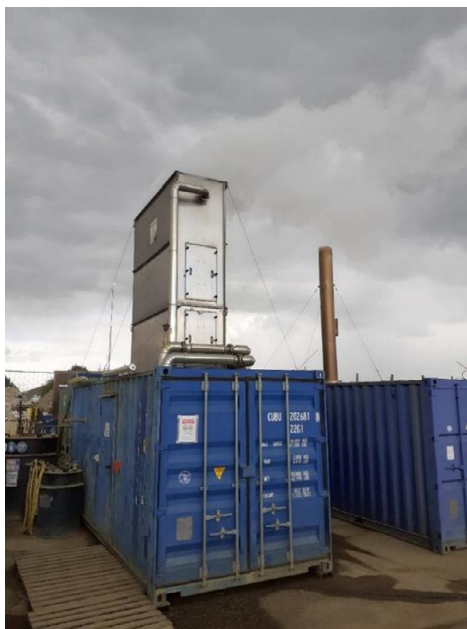
Figure 108 : Installation de valorisation thermique du biogaz : conteneur chaudière (à droite) et conteneur « évaporateur de lixiviats » (à gauche)
