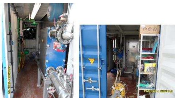
Figure 118 : Exemple de l'intérieur du conteneur d'évaporation des lixiviats
