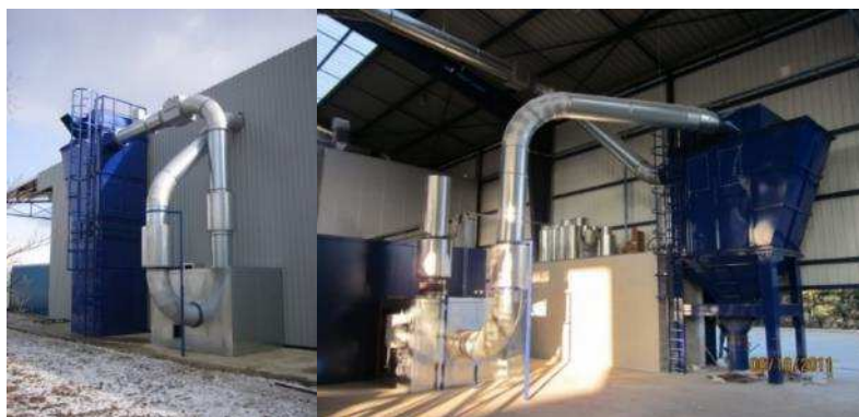
Figure 38 : Exemple de système de dépoussiérage
