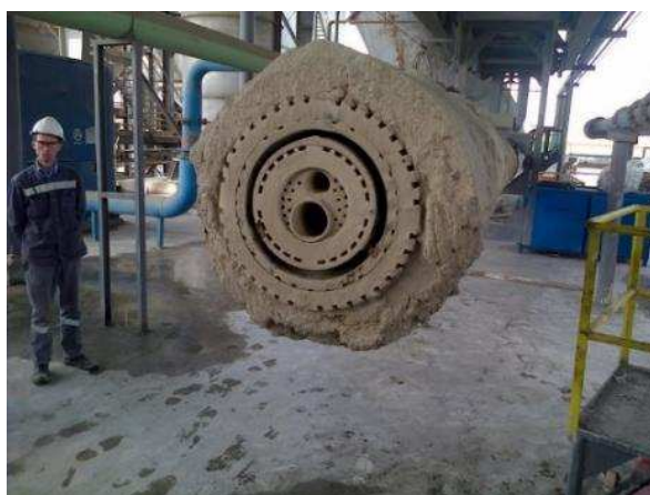
Figure 31 : Exemple tuyères de four de cimenterie
