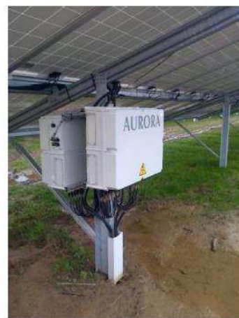
Figure 147 : Boîtier de connexion fixé à l'arrière de panneau
