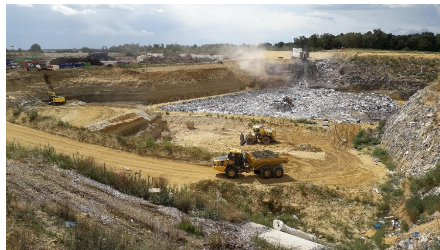
Figure 12 : Photo d'un casier de stockage actuel
