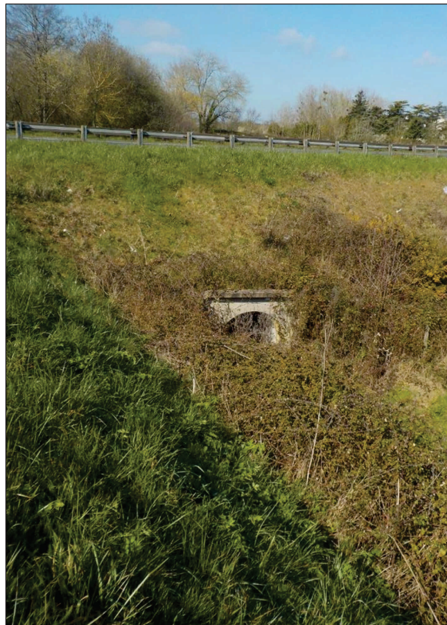
OH 4 au droit ru de la Grée des Bois (coté aval de la RD 923) : Buse de 1600mm
