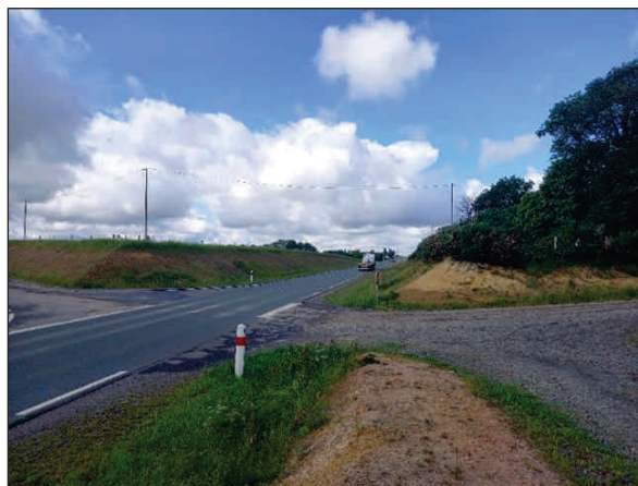
Absence de plantation au niveau du carrefour « Des Domaines » sur la section 4
