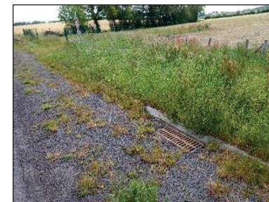
Bordure pour la collecte des eaux de ruissellement vers le bassin de rétention en cas de pollution sur la section 4
