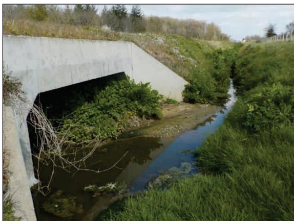
OH 10 : Accumulation de sédiments à la sortie de l'ouvrage
