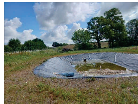
Bassin de rétention aménagé au droit du ruisseau du Gué des Loges sur la section 4 « La Regéserie – Les Loges »
