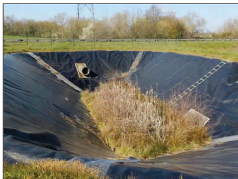
Bassin de rétention aménagé au droit du ruisseau de la Grée des Bois sur la section 1
