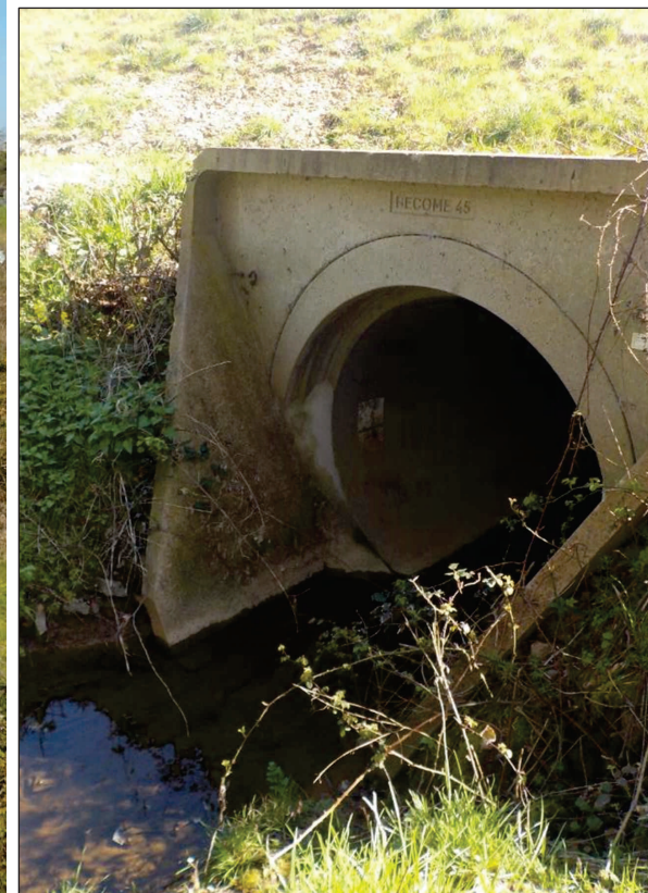
OH 4 au droit ru de la Grée des Bois (coté amont de la RD 923) : Buse de 1600mm
