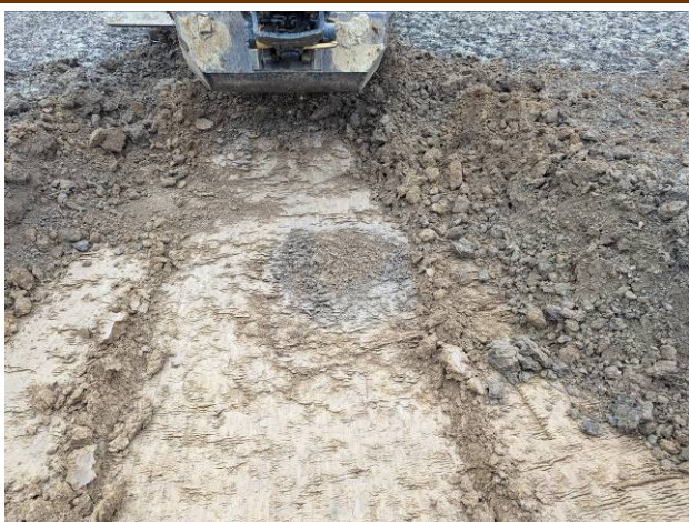
Photographie 3 : Anomalie circulaire (Ø1.1m) de limon brun au droit de l'affaissement dans le terrain naturel composé de limon jaune
