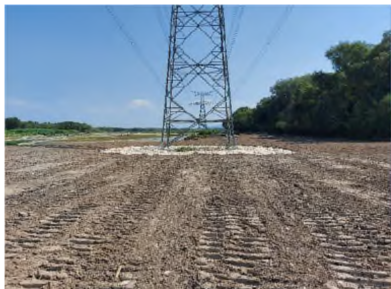
Photo 19 : Pylône 211 dont les enrochements effectués en 2020 sont majoritairement recouverts (source : RTE)
