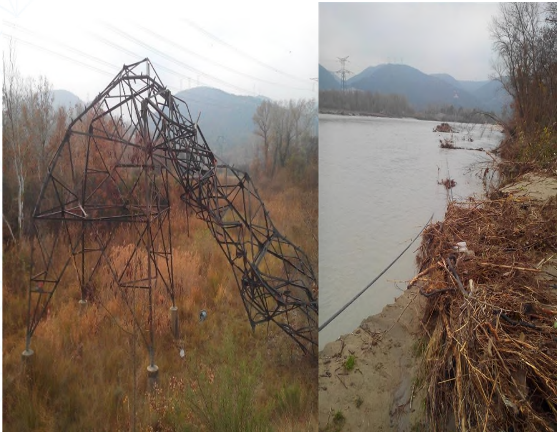
Photo 2 : Impacts de la crue de novembre 2016 sur un pylône de la ligne Saint-Estève – Sainte-Tulle (source : RTE)
