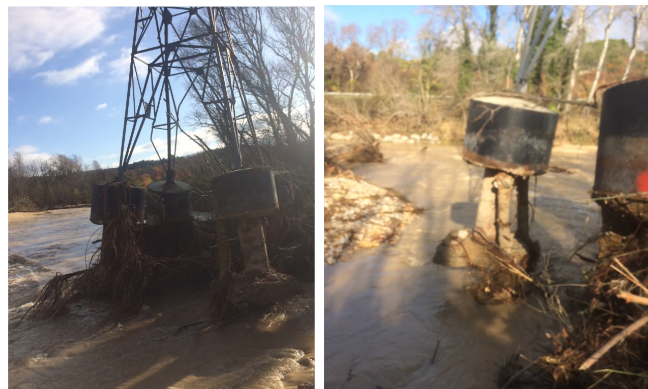
Photo 9 : Illustration des impacts d'une crue de du Calavon sur un pylône 63kV (Apt-Beaumettes) lors des crues de Novembre 2019
