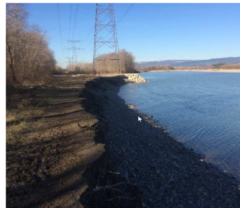
Photo 11 : Illustration de l'érosion latérale au droit du pylône 89 (source : setec, 2018)
