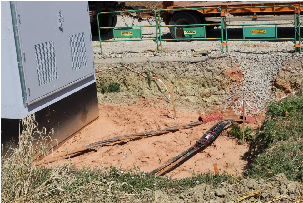
Photo 6 : Câbles souterrains reliant les éoliennes au poste de livraison avant enfouissement
