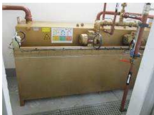
Nourrice sur rétention alimentant les groupes électrogènes présents dans le bâtiment DC02 Dalle béton en bon état
