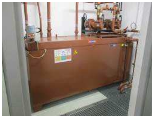
Nourrice sur rétention alimentant les groupes électrogènes présents dans le bâtiment DC08 Dalle béton en bon état
