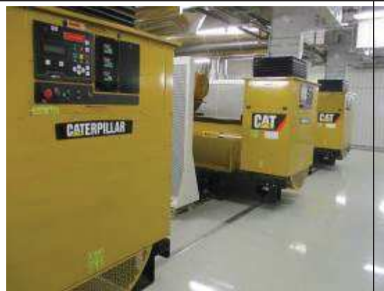
Local groupe électrogène du bâtiment DC08 Dalle béton en bon état
