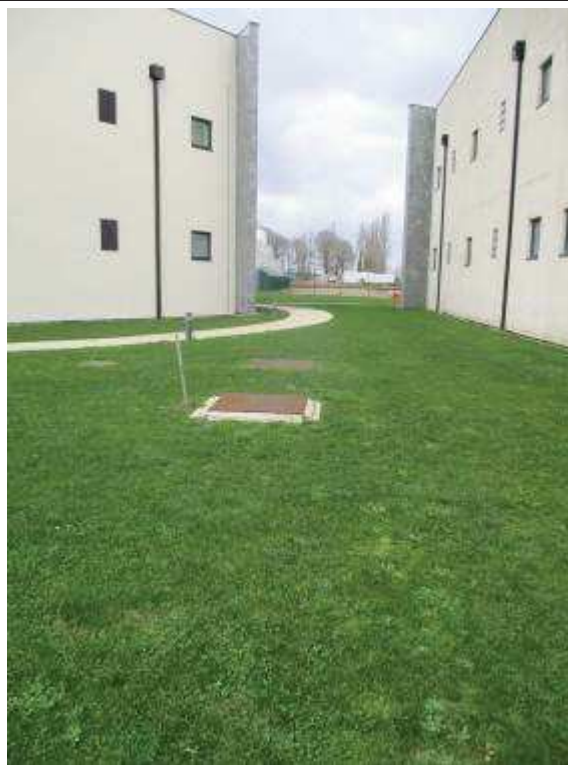
Regard des cuves enterrées de fioul domestique alimentant les groupes électrogènes dédiés au bâtiment DC08
