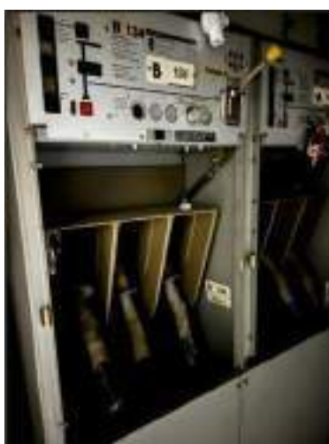
Photographie 21 : Vue sur l'intérieur des transformateurs
