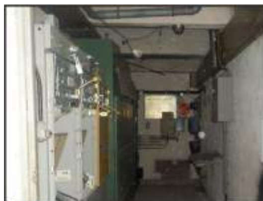
Photographie 20 : Vue sur les transformateurs
