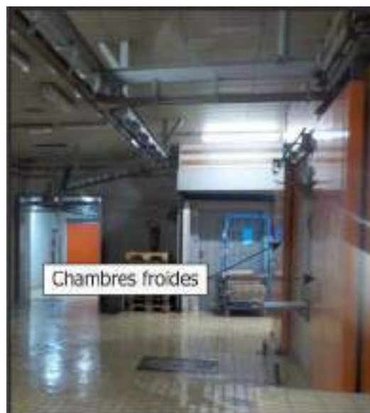
Photographie 10 : Vue sur d'autres chambres froides présentes dans la boucherie
