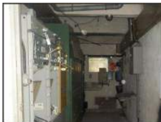
Photographie 20 : Vue sur les transformateurs
