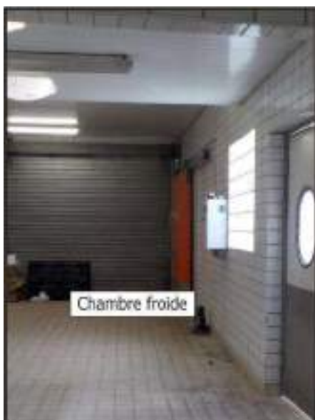
Photographie 9 : Vue sur une chambre froide présente dans la boucherie
