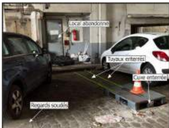
Photographie 24 : Vue sur le regard dégradé menant à une cuve enterrée
