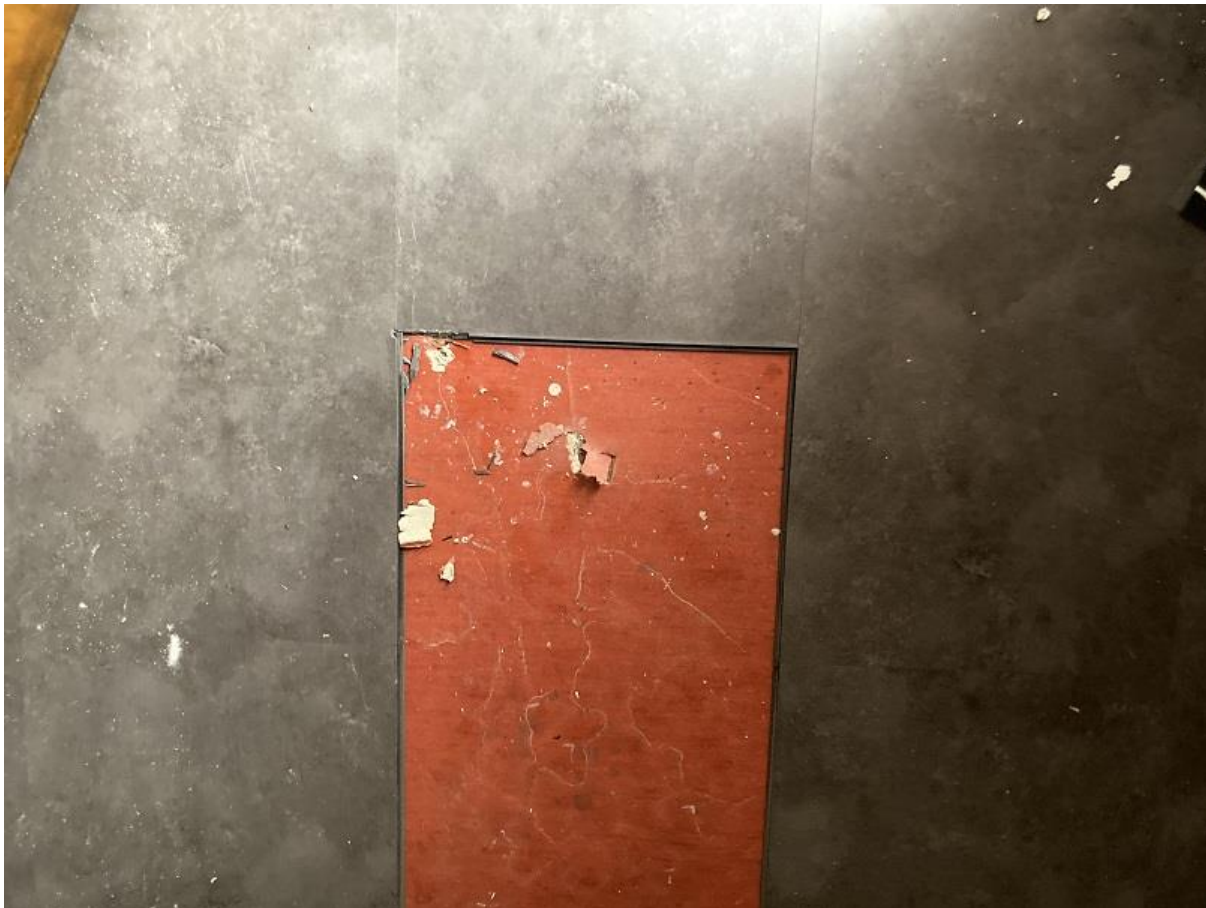
Le linoleum rouge contient des fibres d'amiante.
