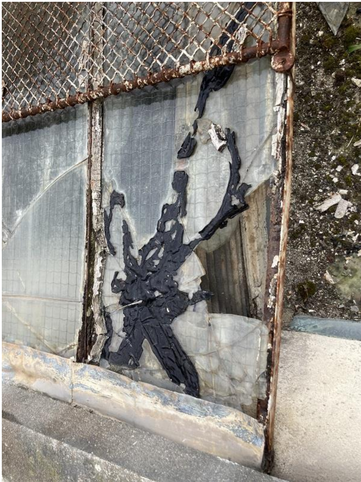
Prélèvement n°52 : Le revêtement bitumineux sur la verrière contient de l'amiante après analyse en laboratoire.
