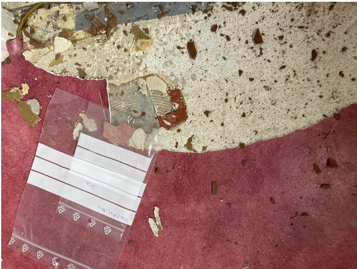
Prélèvement n°17 : Le linoleum rouge (situé sous le linoleum de couleur rose) contient de l'amiante après analyse en laboratoire.
