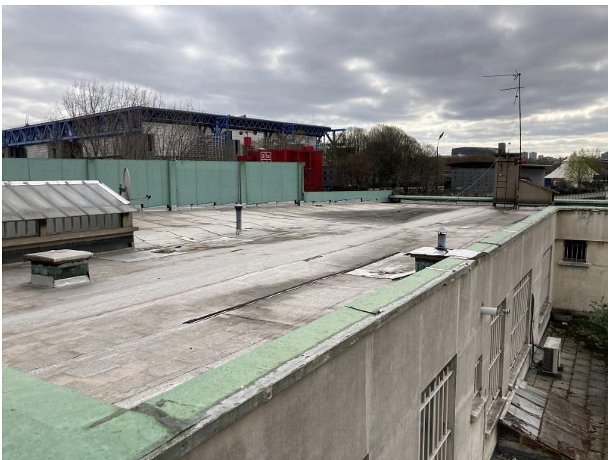
Vue partielle de la toiture terrasse : Tous les revêtements bitumineux d'étanchéité, sur sol, en relevé, sur acrotères, ... contiennent de l'amiante après analyse en laboratoire.
