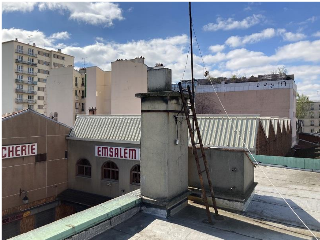
Présence d'un conduit fibres ciment contenant de l'amiante sur souche en bordure.
