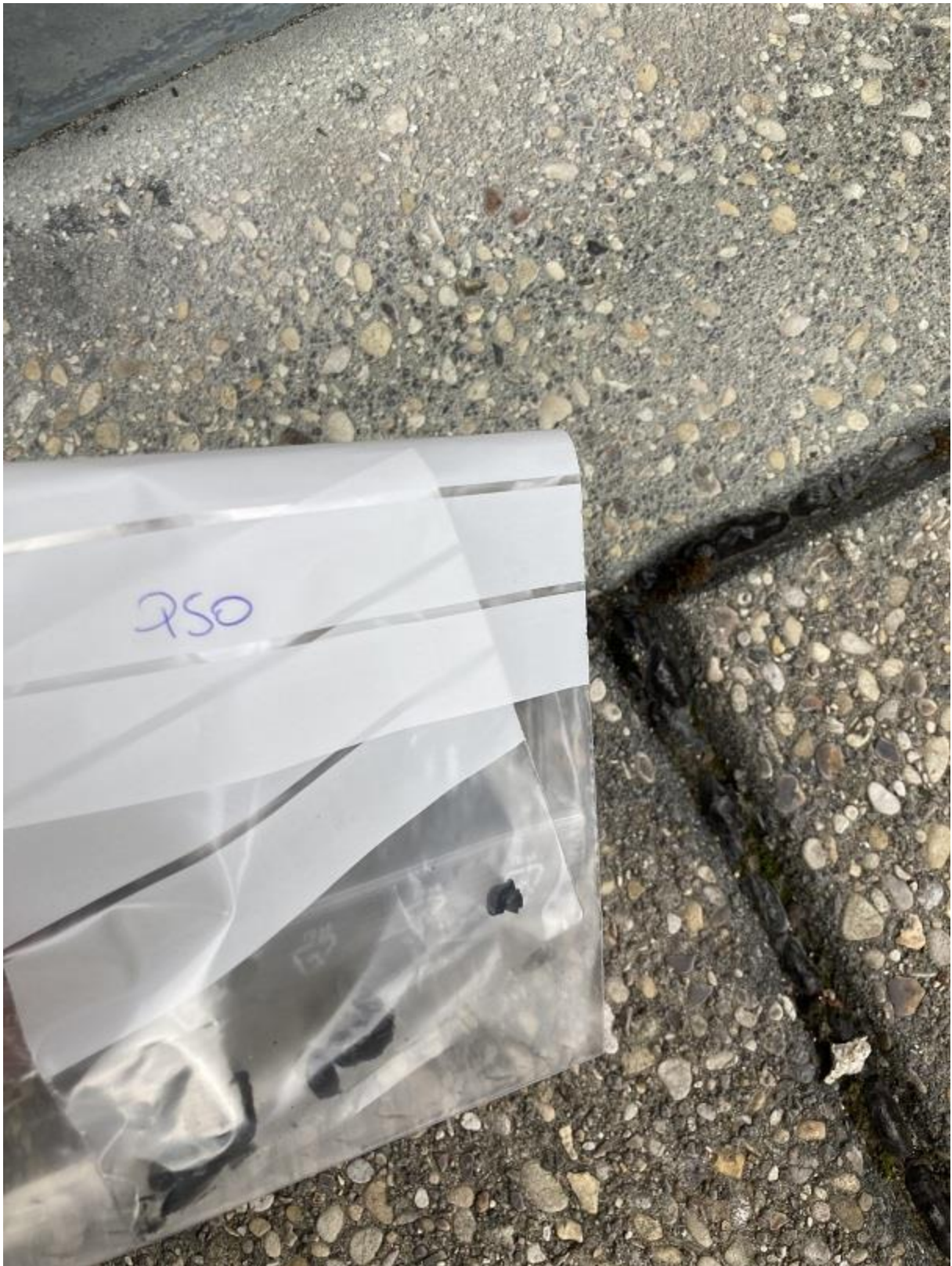
Prélèvement n°50 : Les joints bitumineux entre les plaques béton au sol contiennent de l'amiante après analyse en laboratoire.
