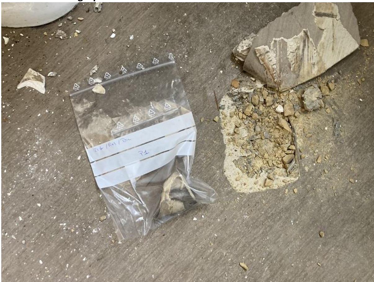
Prélèvement n°1 : Le linoleum contient de l'amiante après analyse en laboratoire.
