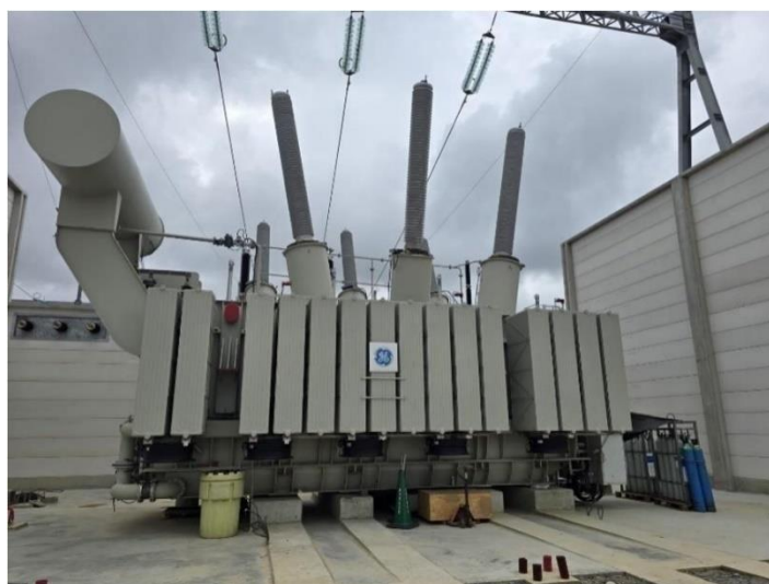
Figure 3 : Photographie d'un transformateur
