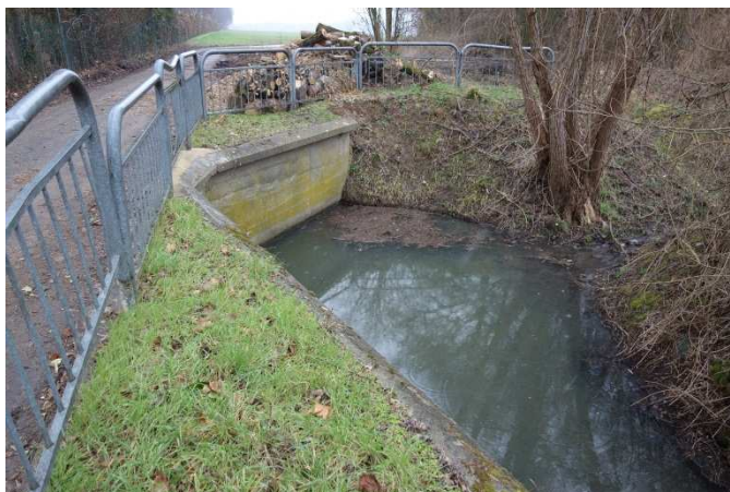
Fig. 17. Arrivée du Ru de Gironde dans un bassin
