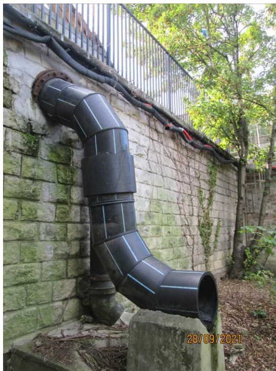
Figure 38 : Photo de la canalisation de rejet sur le quai de l'Yerres des effluents refoulés par la station PY en situation de crue
