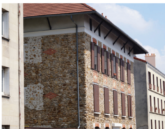
Les reprises du parement en meulière du pignon sont très visibles et soulignent les difficultés rencontrées dans la restitution de ce type de parement
