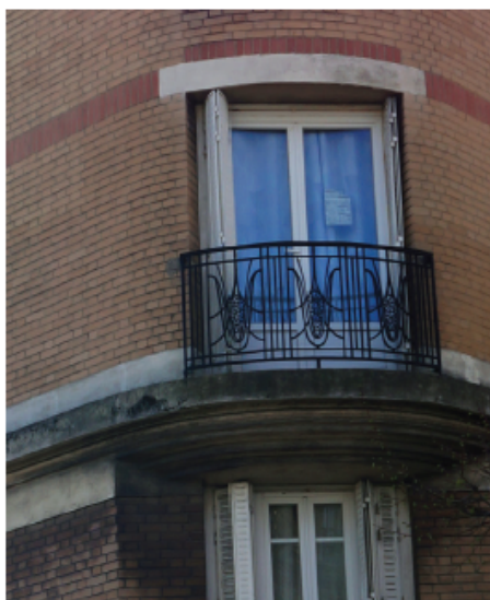
Détail de la façade : corniche, différences de couleurs entre les briques
