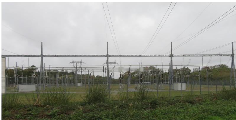
Le poste électrique vu du chemin d'accès
