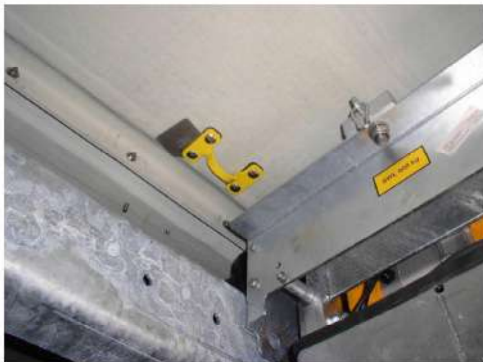
Illustration 22-5 : Point d'ancrage situé sur le toit, au niveau du treuil.
