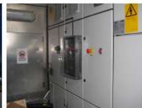
Illustration 15-6 : Bouton d'arrêt d'urgence et interrupteur F60 situés sur l'unité centrale de la nacelle.
