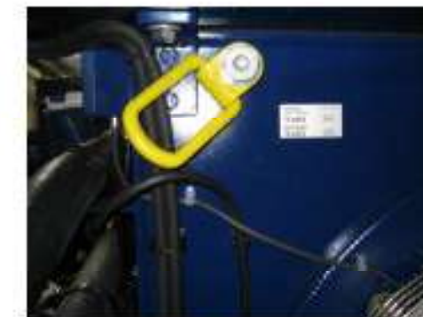
Illustration 22-3 : Point d'ancrage situé sur le générateur, près de la trappe au sol.
