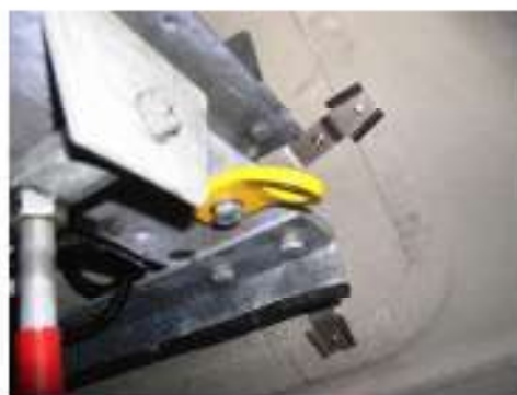
Illustration 22-6 : Point d'ancrage situé au niveau du rail du treuil.
