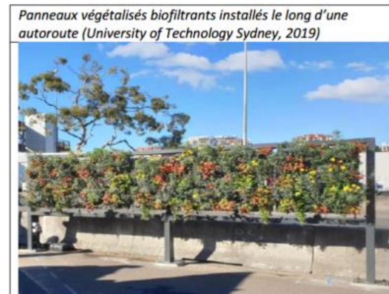
Figure 25 : systèmes de biofiltration d'air
