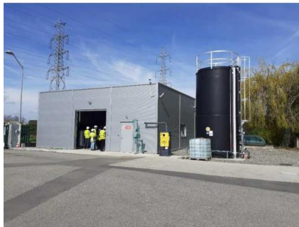
Figure n°147. Station de production des EUT sur le site de Toulouse Ginestous Garonne
