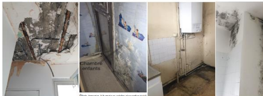
Les Nouvelles de Châtenay-Malabry de décembre 2020
