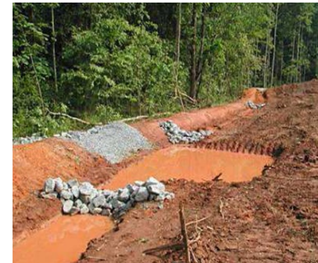
Figure 116 : Exemple de bassin intermédiaire équipé de filtres à fines [AFB]
