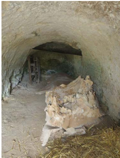
Photo 2 : Cavité sous la rue des Fours à Chaux
