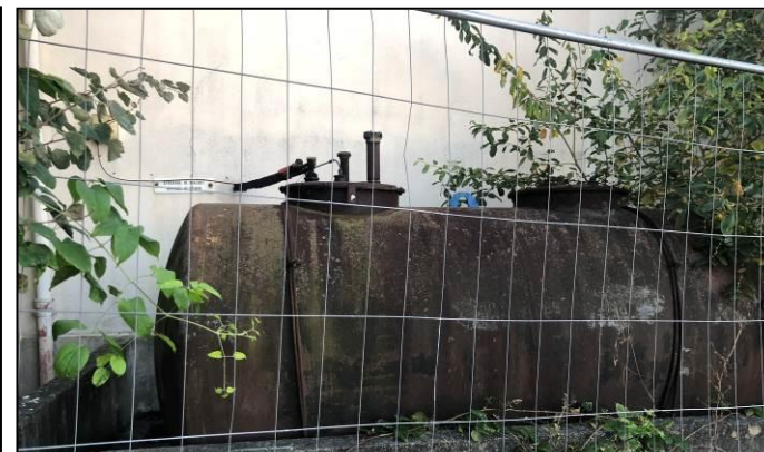
Photographie n°36 – cuve à fuel sur rétention à l'avant du bâtiment énergie (Z70 – ERG)
