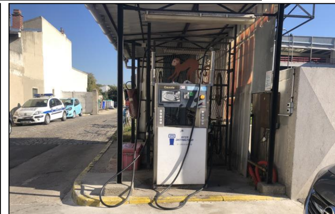
Photographie n°9 – Aire de distribution - volucompteurs
