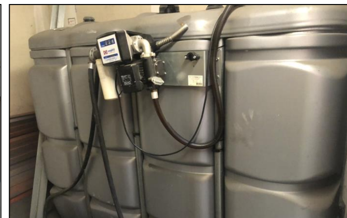
Photographie n°6 – Cuve à fuel à l'intérieur de l'entrepôt et traces de souillures au sol
