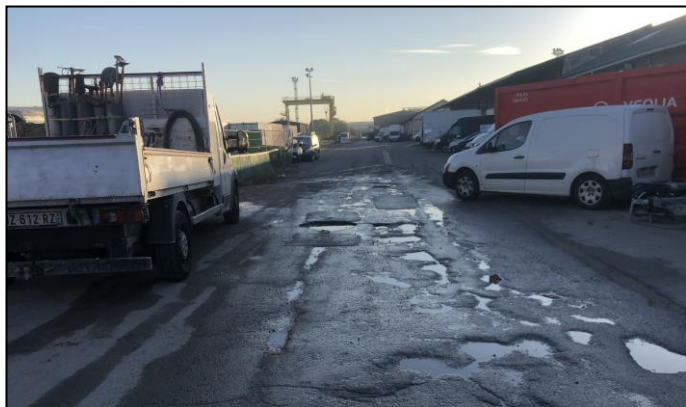
Photographie n°43 – Espaces extérieurs (enrobé en mauvais état favorisant les infiltrations)
