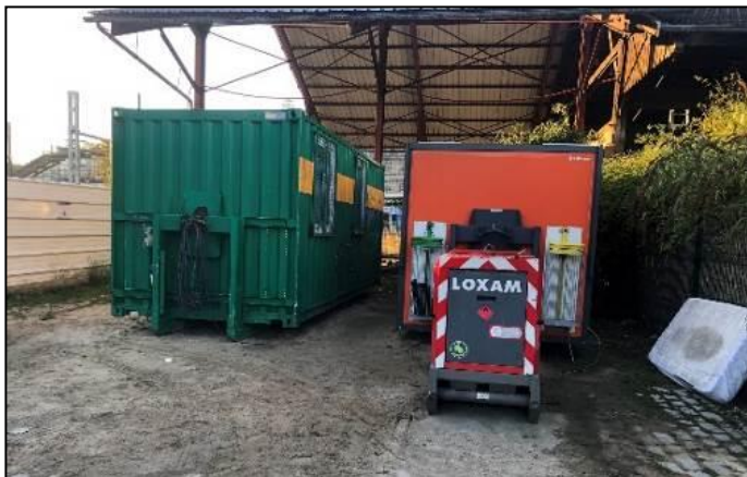
Photographie n°24 – Container et groupe électrogène
