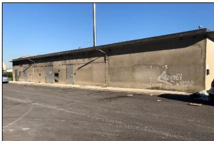
Photographie n°35 – Chaufferie
