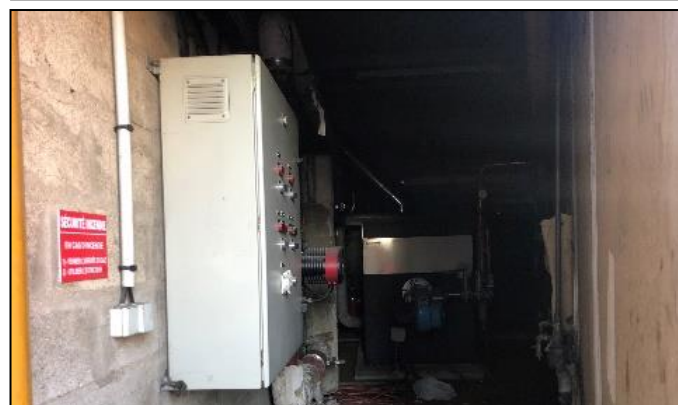
Photographie n°6 – Chaufferie dans l'angle du bâtiment Lemon Tri
