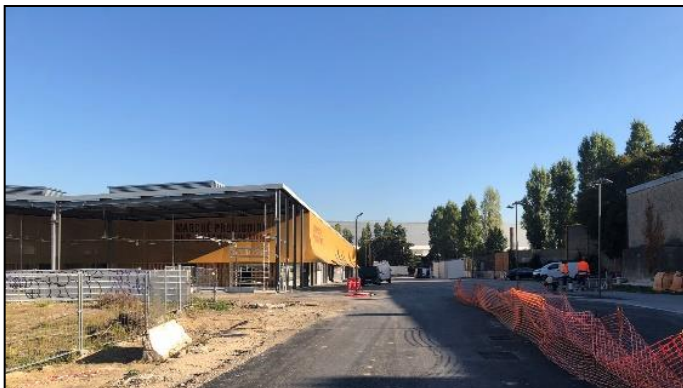
Photographie n°3 – Entrée- bâtiment du marché et zone en friche
