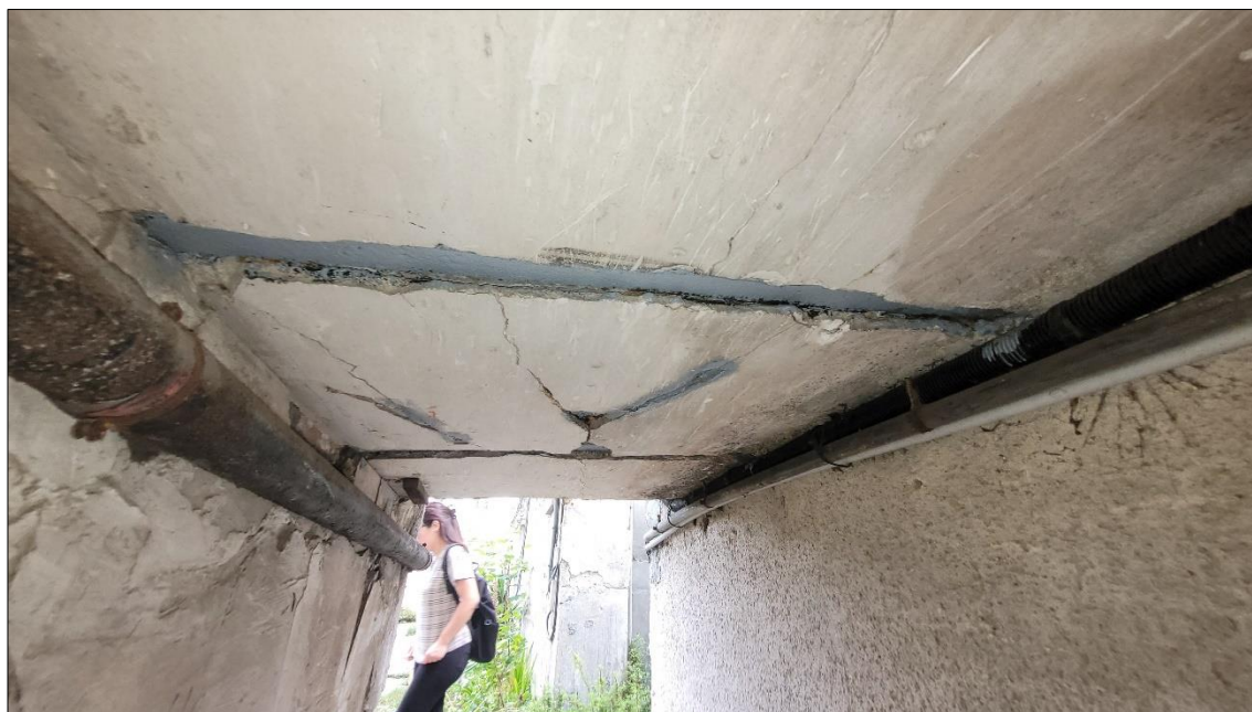
Cliché n° 14 : fissure en plafond et solivage corrodé en plancher haut du passage vers la cour
