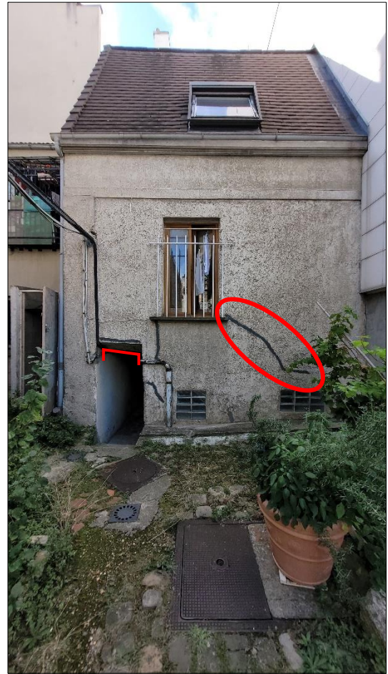
Cliché n° 16 : fissure oblique en façade sur cour du pavillon et déformation du plancher haut du passage vers la cour
