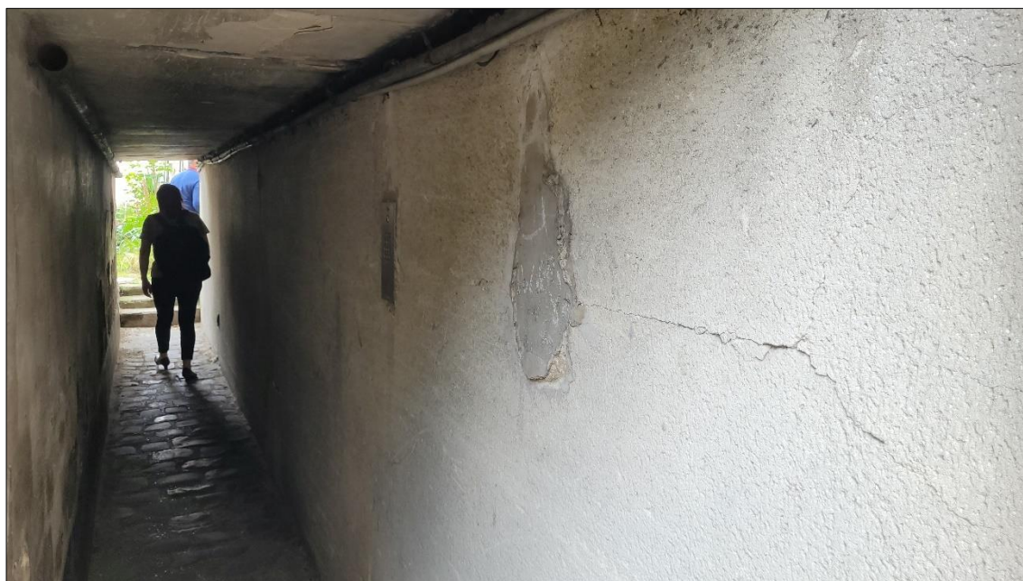
Cliché n° 13 : fissure et dégradation ponctuelle d'enduit sur le mur séparatif dans le passage vers la cour
