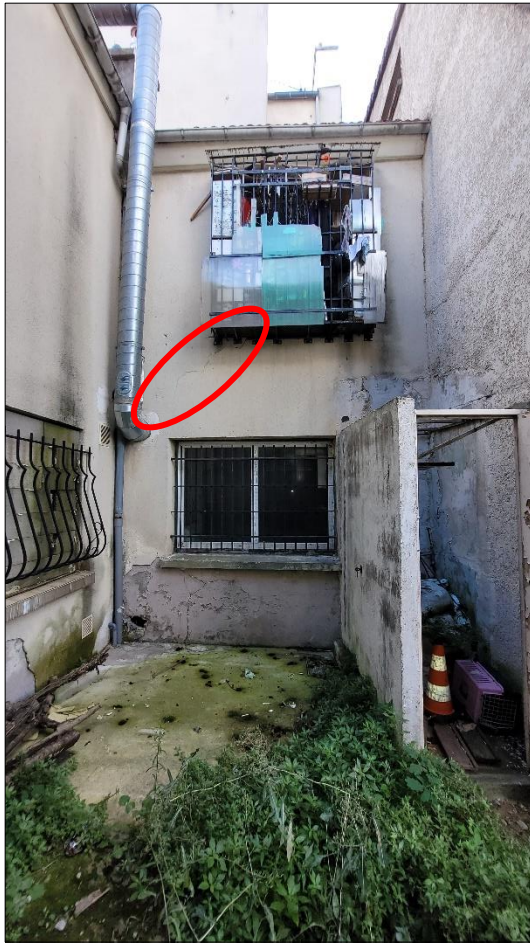
Cliché n° 15 : fissure oblique en façade sur cour du bâtiment envisagé démoli
