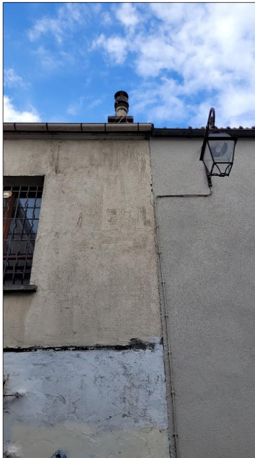
Cliché n° 22 : fissure verticale en façade sur rue au niveau du mur séparatif en zone C
