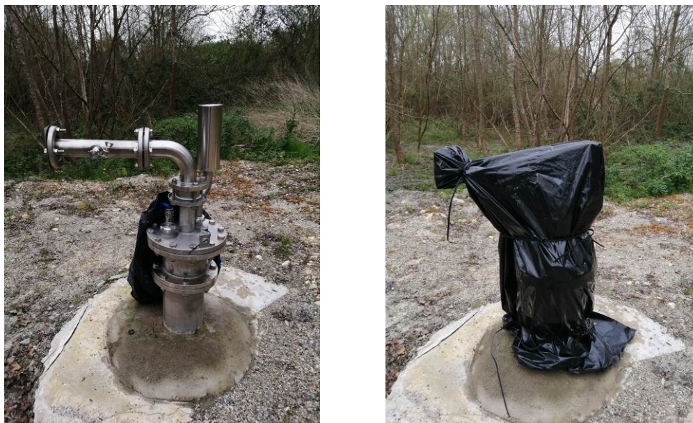
Figure 3 : Photographies de la tête de puits du forage F3 JOLIVAL en avril 2025 (SAS OVAL)
