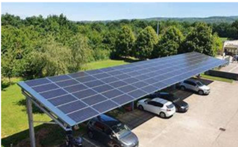
Figure 5 : Exemple d'ombrières photovoltaïques sur places de stationnement (source : Imogis)
