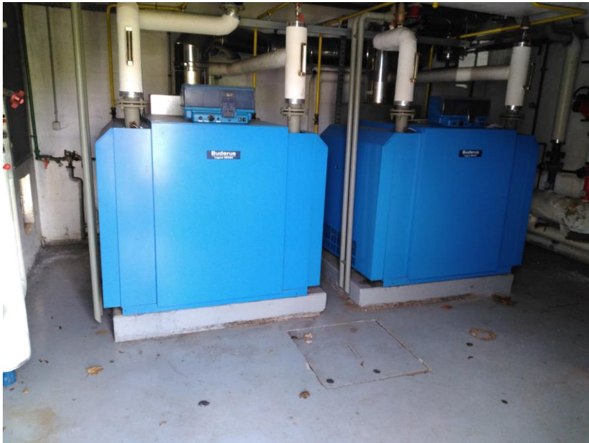
Adélaïde : chaufferie gaz
