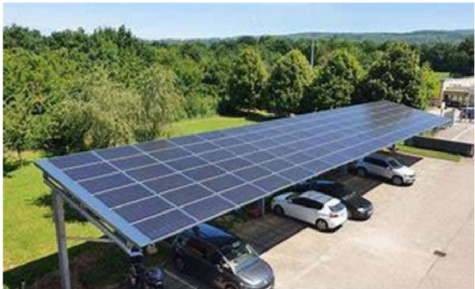
Figure 9 : Exemple d'ombrières photovoltaïques sur places de stationnement (source : Imogis)
