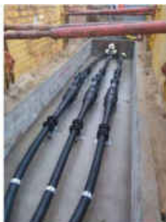
Chambre de jonction
