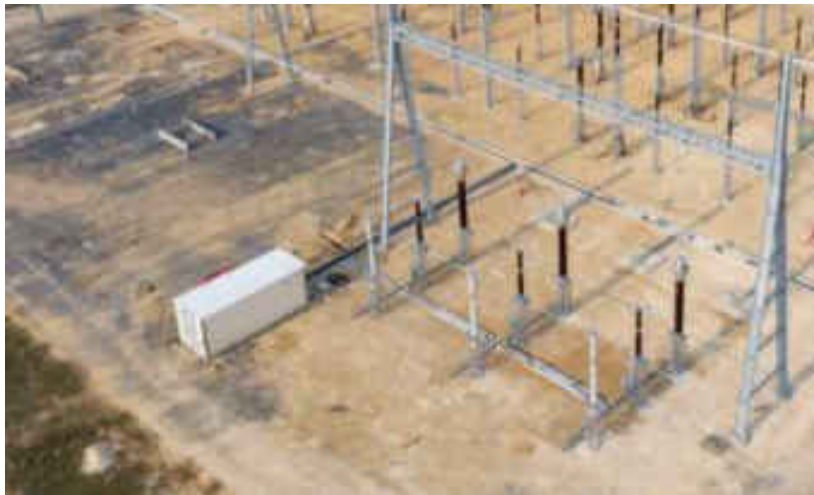
Exemple d’installations dans un poste aérien
