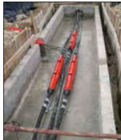
Exemple de chambre de jonction
