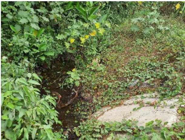
Déviation du ruisseau au passage de la nouvelle piste d'accès, avec l'installation d'une buse qui apparaît sous-dimensionnée par rapport au gabarit du ruisseau
