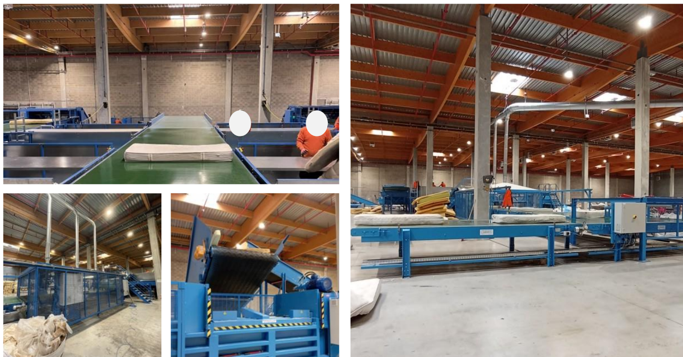
Figure 8 : Photographies des installations de traitement de matelas
