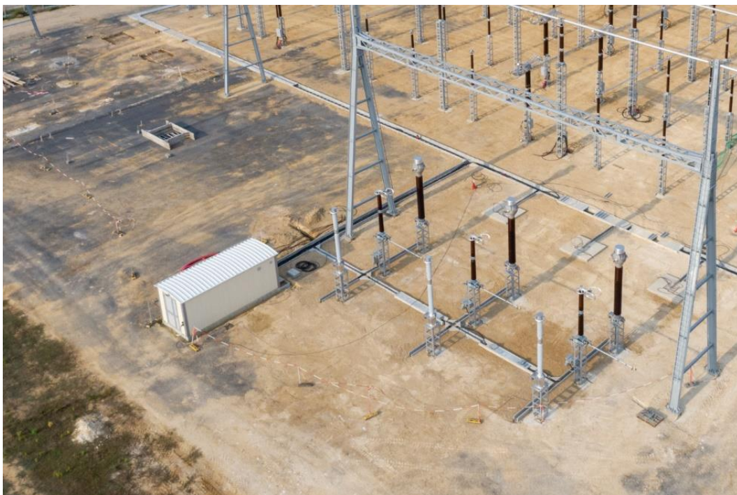
Exemple d'un départ de ligne dans un poste aérien
