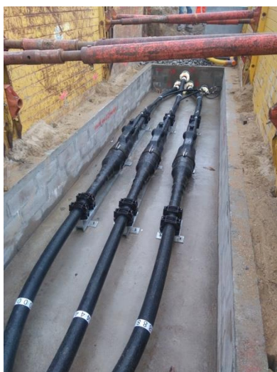
Chambre de jonction
