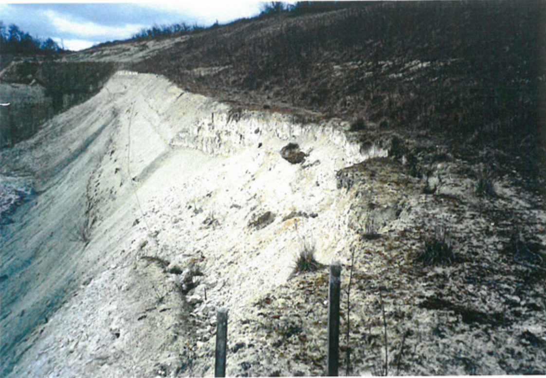
PHOTO 1 : Site de Montzaigle Rupture de talus dans les Marnes de Pantin
