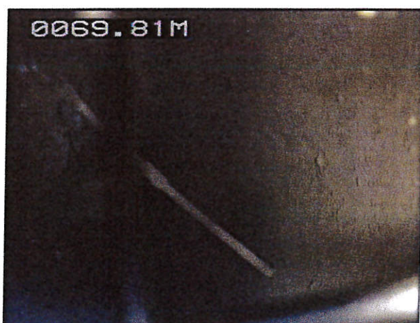
Attache de câble électrique pris dans le concrétionnement
