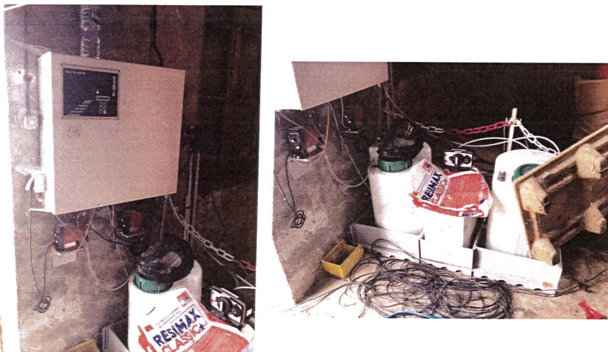
Figure 15 : Aperçu du système de désinfection avec adoucissement de l’eau
