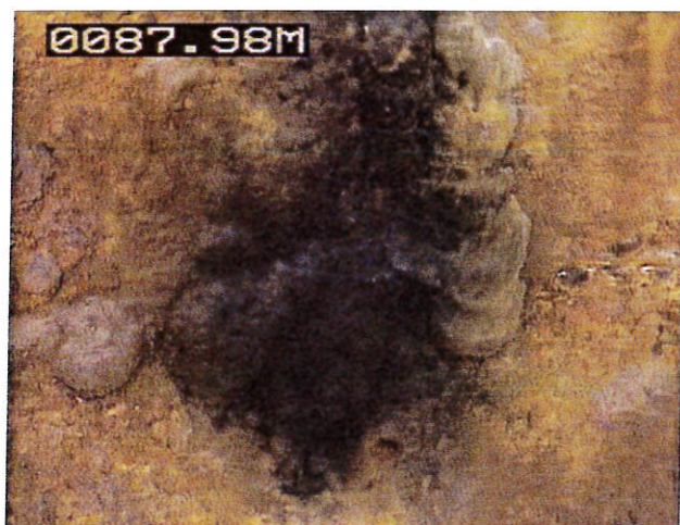
Concrétion avec oxydes métalliques qui s'est développée sur une zone de jonctions
