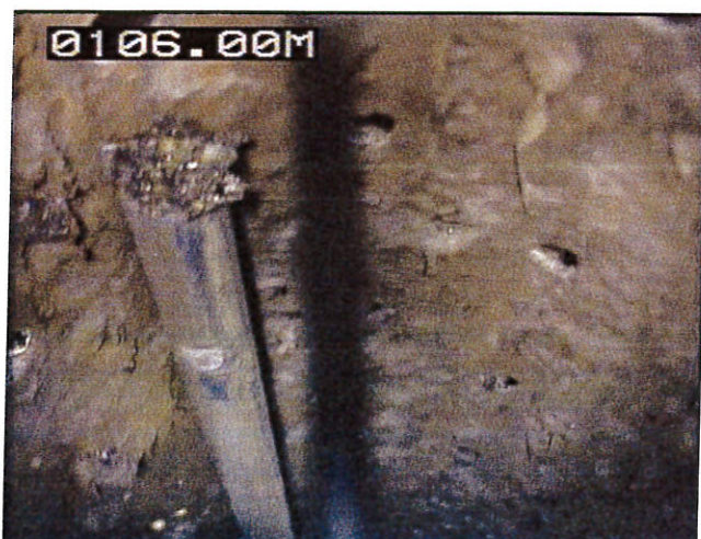
Second tronçon de tube (PVC ?) échoué en fond d'ouvrage à partir de 106,10 m , absence de bride et de sectionnement net ?
