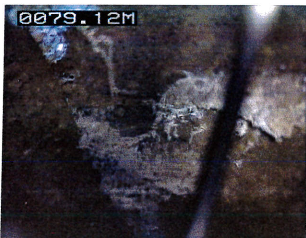
Coulure de ciment depuis la jointure des tubages
