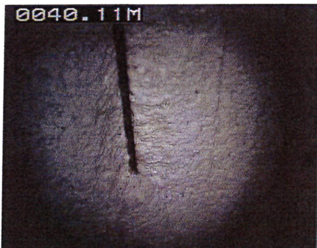
0040.11M Ferrure rectiligne prise dans la paroi du cuvelage (absence de suintements)
