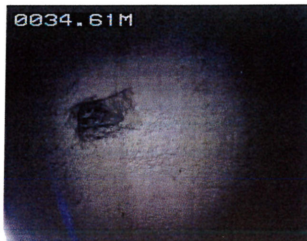
0034.61M Renforcement très prononcé dans le cuvelage (absence de suintement)
