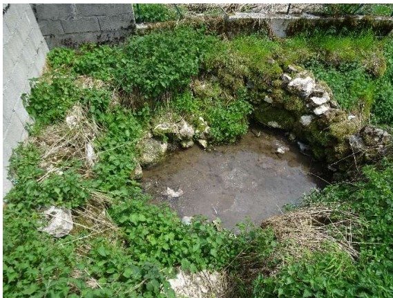
Bac de décantation
