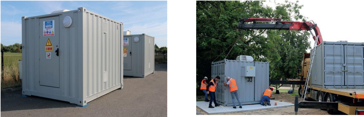
Figure 4 : photographies de composants de sous-stations électriques
