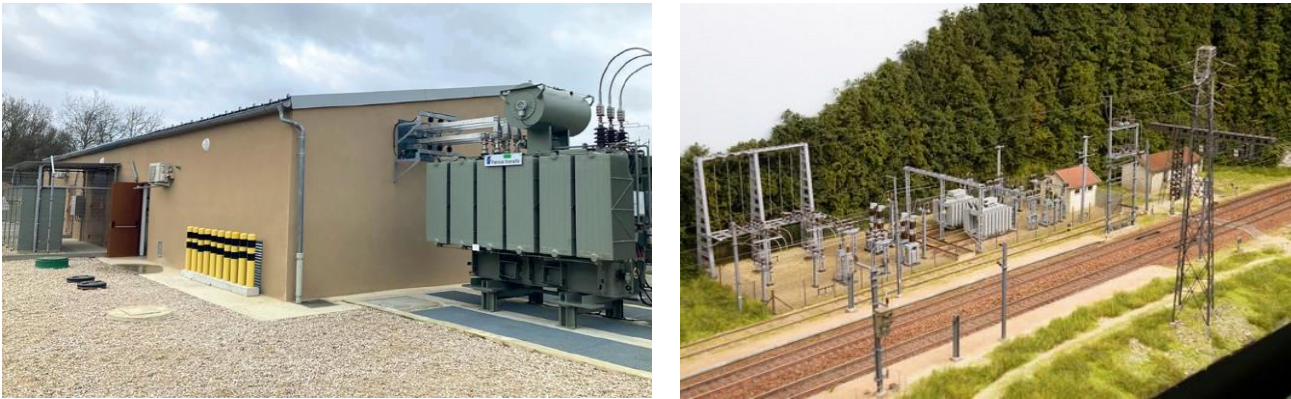
Figure 3 : photographies de composants de sous-stations électriques
