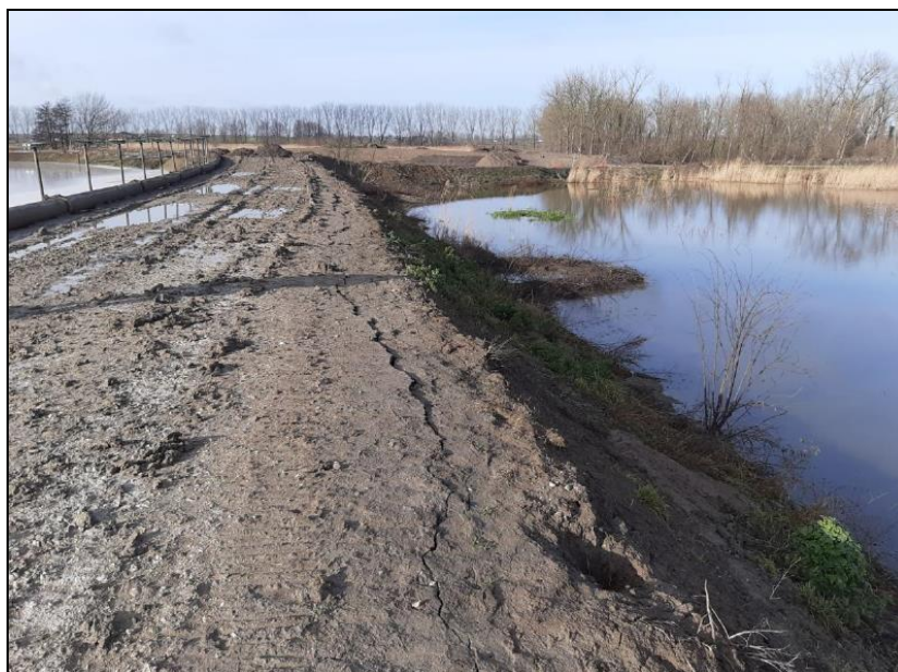
Figure 28 : Crête B11/B10 – ligne de fissuration en crête
