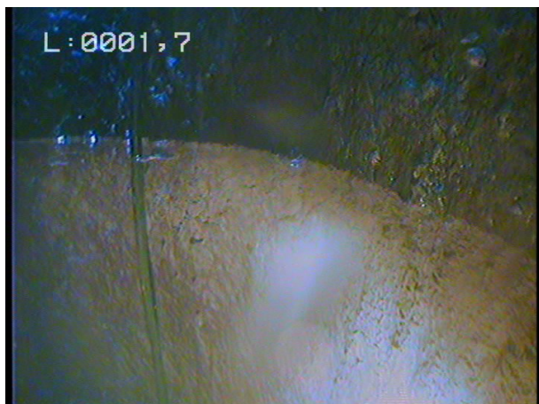
Vue sur le niveau d'eau
