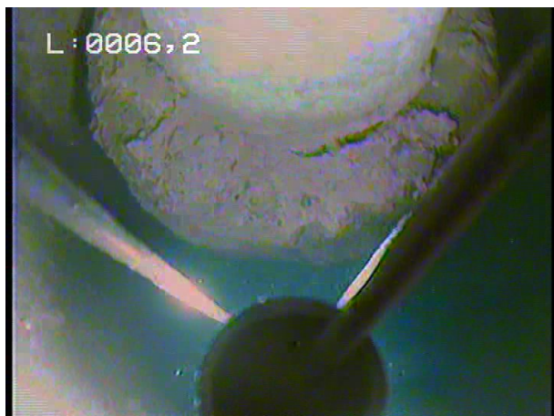
Bride de la pompe encroutée
