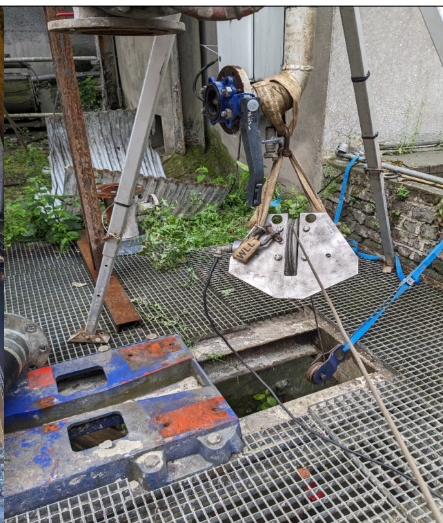
Installation sur le F2
