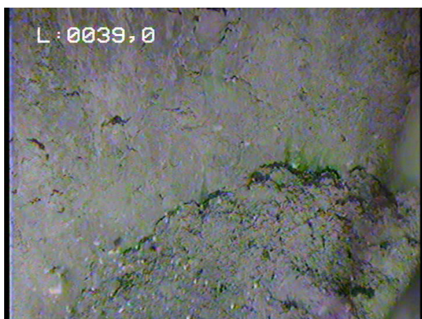
Vue sur le fond, paroi nappée d'un dépôt
