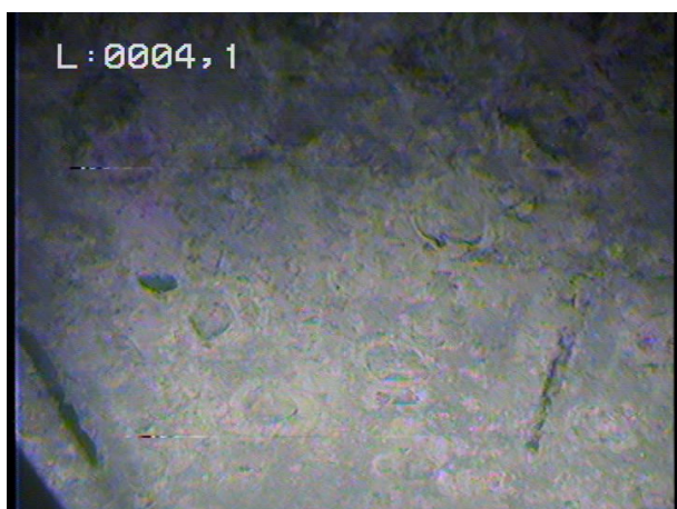
Paroi avec dépôt et crépine en partie ouverte
