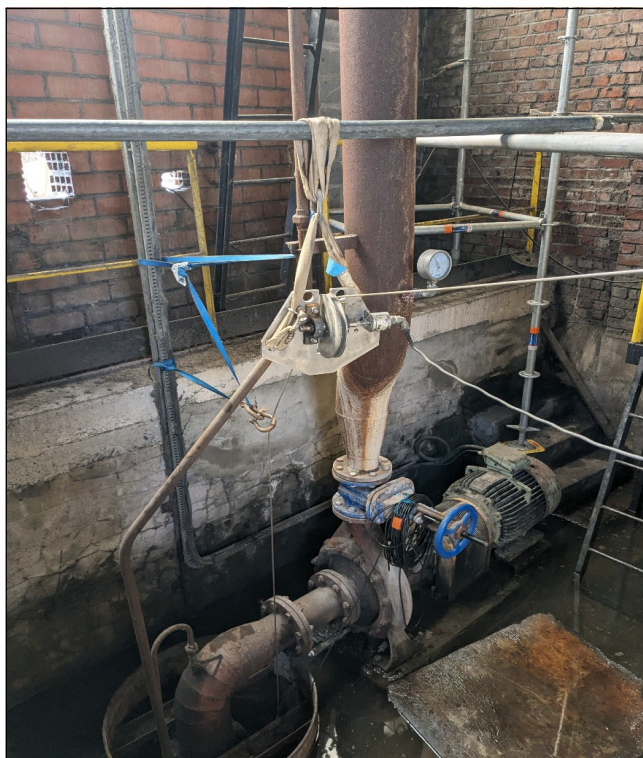
Installation sur le F4
