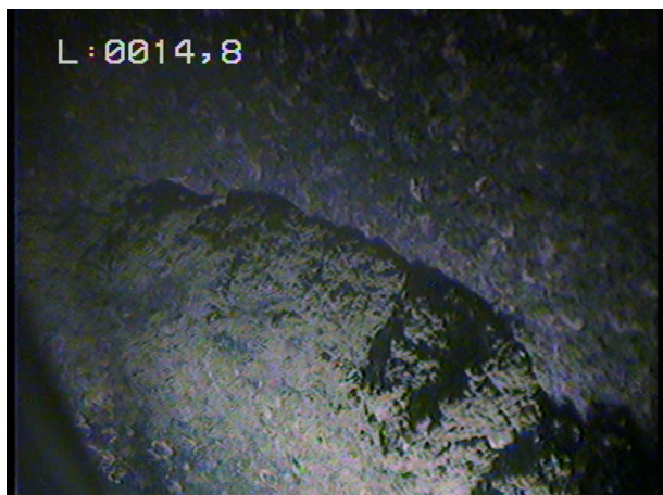
15m : réduction de diamètre Dépôt meuble sur la réduction
