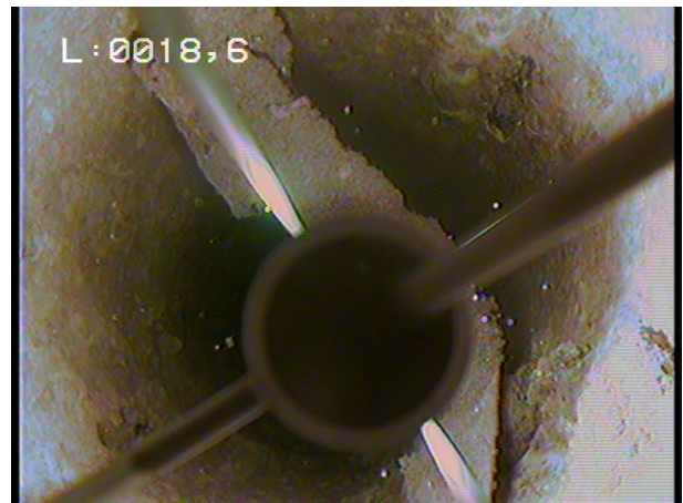
Vue sur un obstacle en travers
