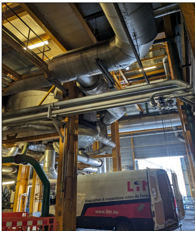
Installation sur le F1
