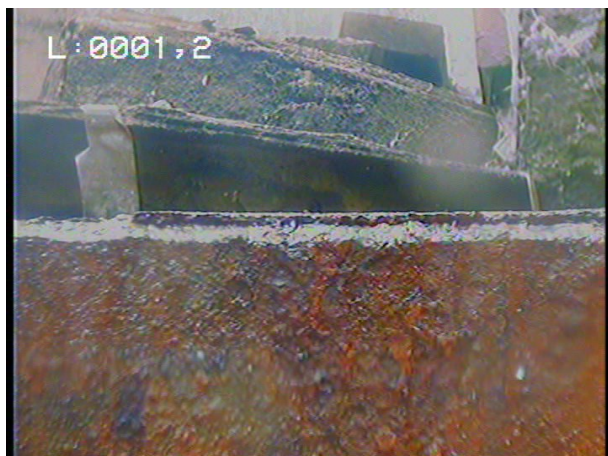
Niveau d'eau à 1.30m, tubage plein (diamètre intérieur 350mm)
