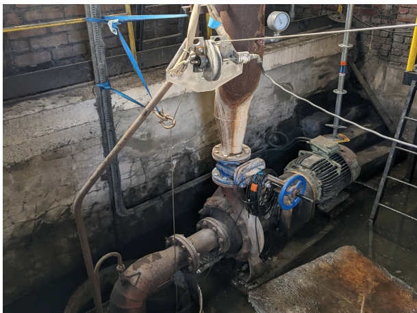
Vue de l'installation Référence des mesures au niveau du sol de la porte d'entrée
