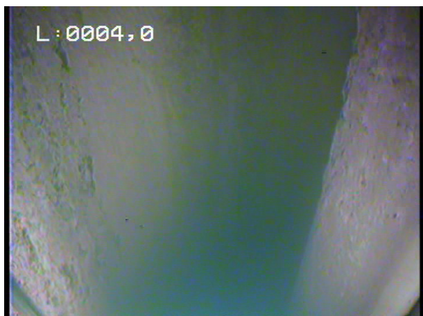
Paroi oxydée légèrement corrodée
