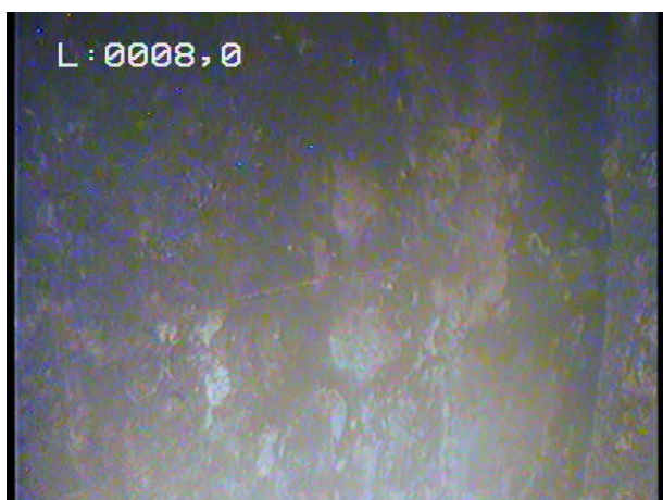
Paroi oxydée, joint visible
