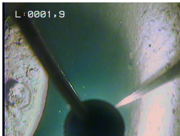
Bride de la colonne de pompe, corrodée avec dépôt
