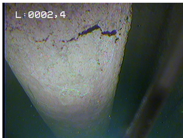
Colonne de pompe avec dépôt, eau claire
