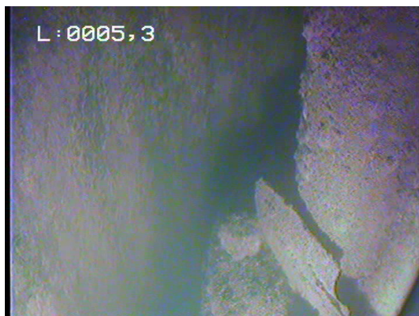
Vue sur une bride de la colonne de pompe à 5.6m.
