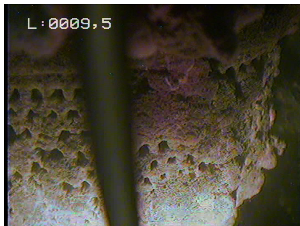
Crépine d'aspiration de la pompe fortement colmatée
