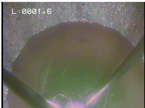
Niveau d'eau à 1.80m, tubage plein (diamètre intérieur 295mm)
