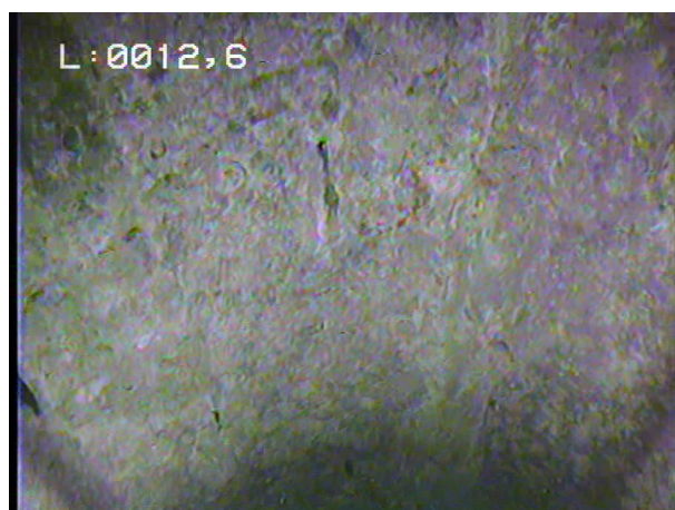
Paroi oxydée avec concrétions
