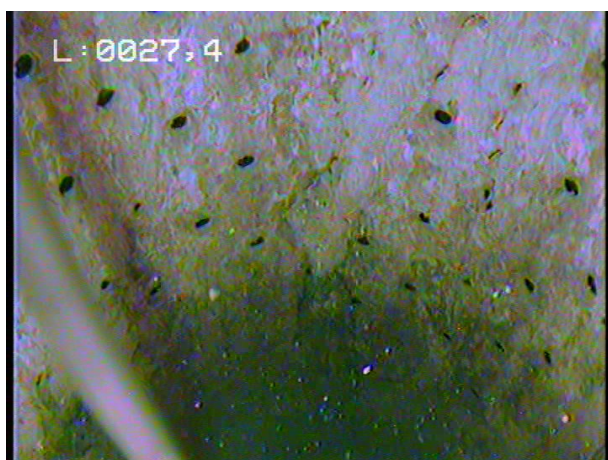
Crépine ouverte avec paroi encroutée
