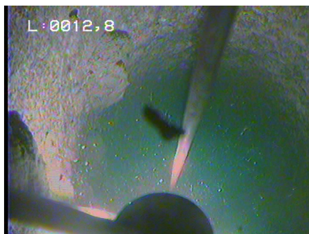
Vue d'ensemble, quelques nodules indurés sur la paroi.
