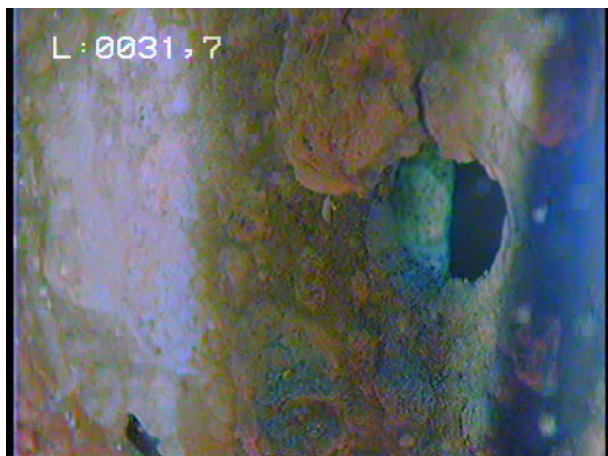
Vue sur la craie à travers la crépine, espace annulaire non rempli
