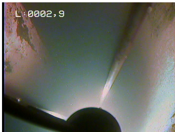
Eau turbide, colonne de pompe sur la gauche de l'image
