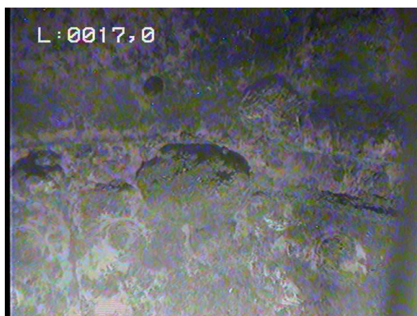
Vue sur un joint, légèrement oxydé
