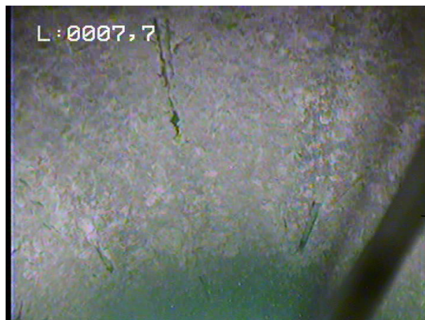
Crépines partiellement colmatées
