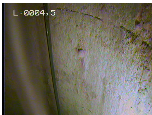
Vue sur un joint
