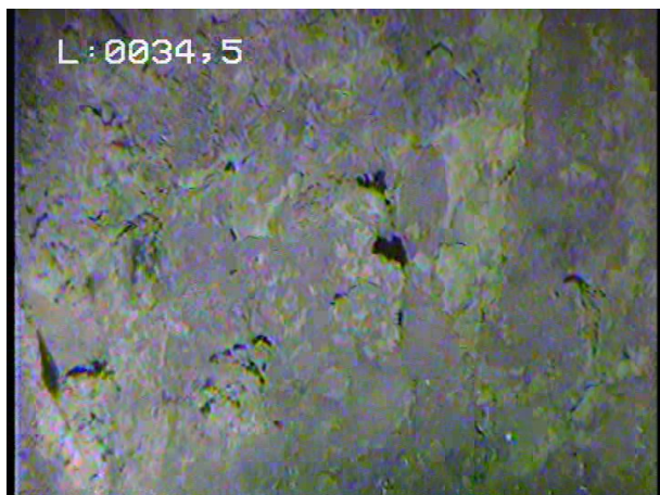
Paroi avec dépôt induré, crépine non visible
