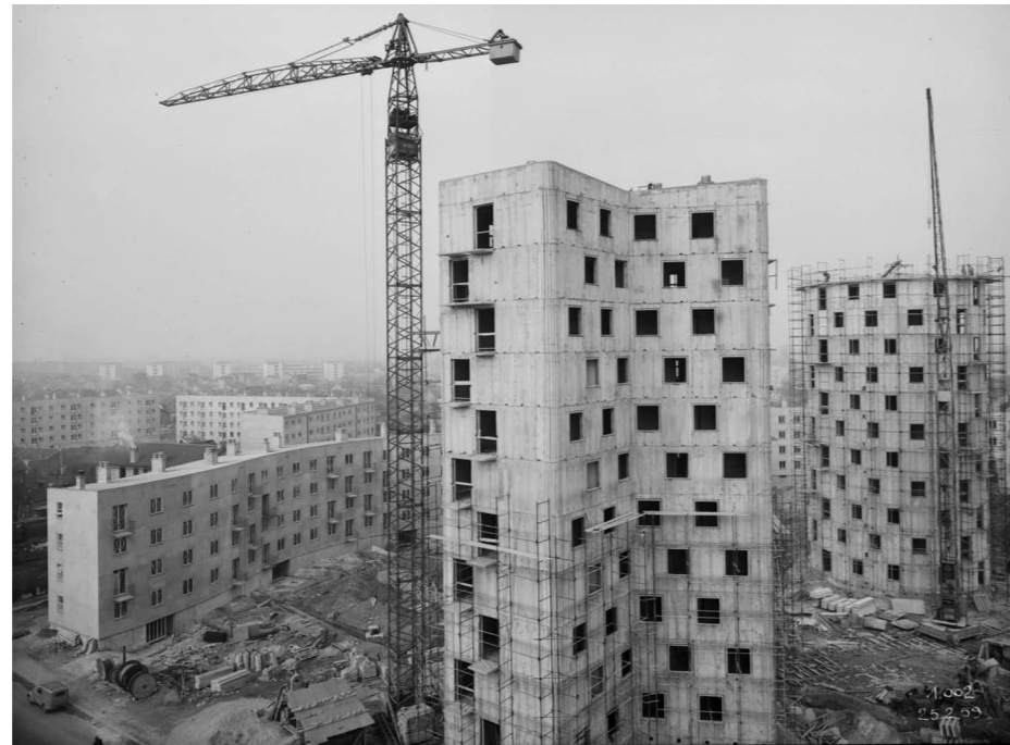
Cité de l'abreuvoir, les tours 3 ème tranche en chantier, photographie Henri BARANGER pour OTH, datée du 25 février 1959, AD 93
